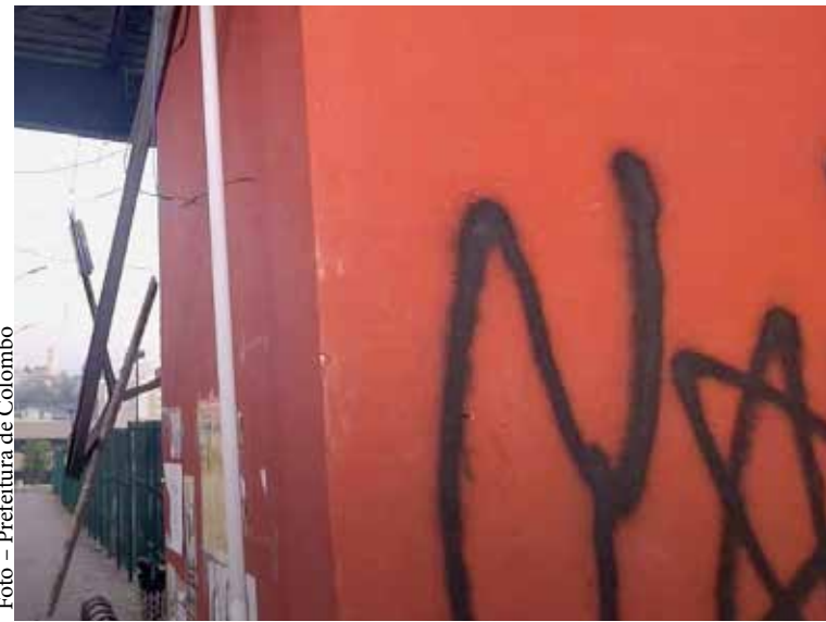
Terminais de ônibus nos bairros Maracanã e Guaraituba sofrem com furtos e depredações frequentes.
